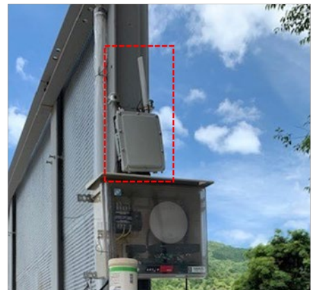
坑外に設置したゲートウェイ(受信機)
