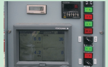
注入量を正確に表示する流量圧力監視装置
